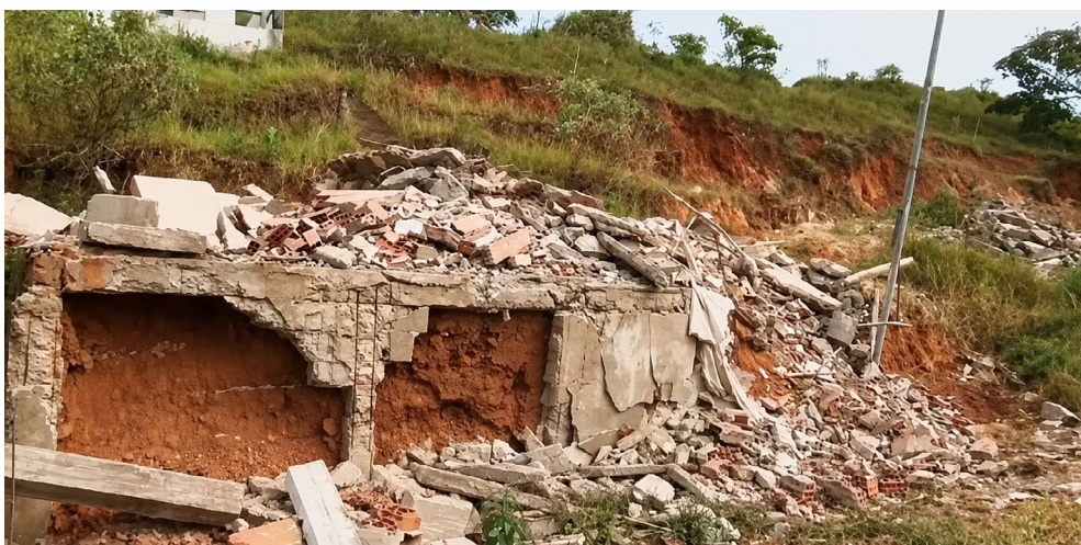
Erosão destruiu casas no Bairro progresso (crédito da foto: print de vídeo da TV Educar).
