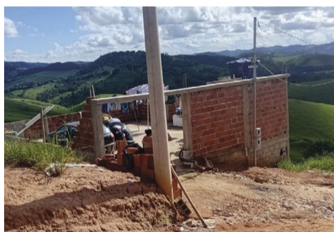
2 Esta casa, em construção, localizada na Rua Mauro Moreira dos Santos, nº 682, não tem água, mas agora o cenário pode mudar (crédito da foto: Ricardo Motta/Líder Notícias)
