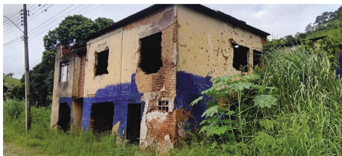
1 Casa abandonada na Rua Desembargadora Paula Motta (Vila Oliveira), trem que ser demolida, pois está em APP, área alagável do Ribeirão Vau Açu (crédito da foto: Ricardo Motta/Líder Notícias)
