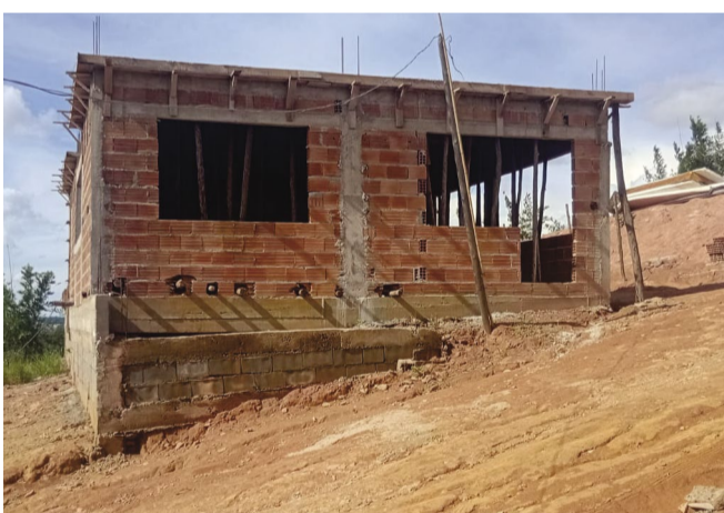
A casa de Luiz Felipe Pituca está sendo construída com água do vizinho
