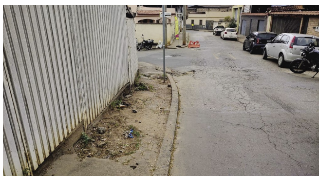
Calçadas de Ponte Nova estão em situação precária (crédito da foto: Diego Siman/Líder Notícias)
