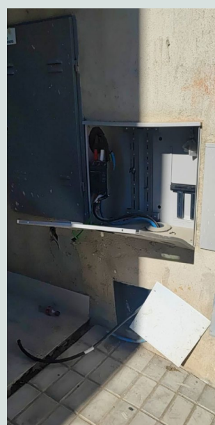
Os ladrões arrombaram a caixa de energia e levaram os cabos (crédito da foto: divulgação da PM)
