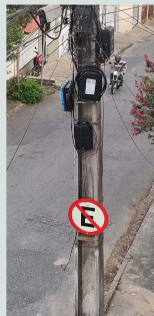
Fio e cabos dependurados no Bairro Santo Antônio, em Ponte Nova
