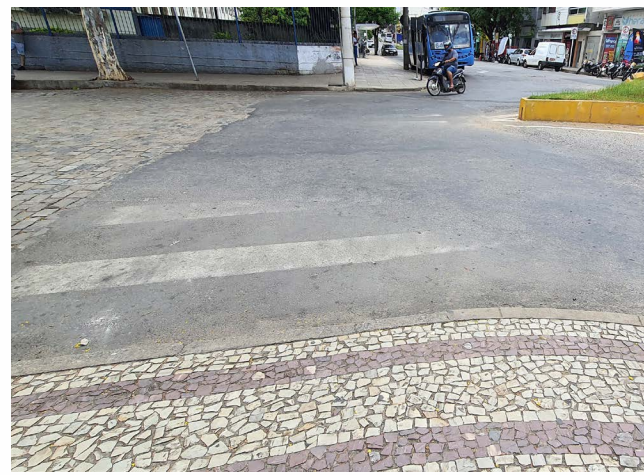
Faixa de pedestre nas proximidades da Escola Municipal Dr. José Mariano, em Palmeiras, quase invisível
