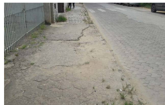
Esta calçada completamente irregular, que prejudica a locomoção de idosos e pessoas com deficiência, fica na parte de baixo da Rua Assad Zaidan, em Palmeiras
