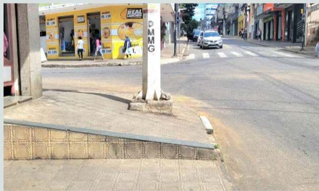
Calçada irregular e degrau fora de padrão: o proprietário foi notificado e pode ser multado
