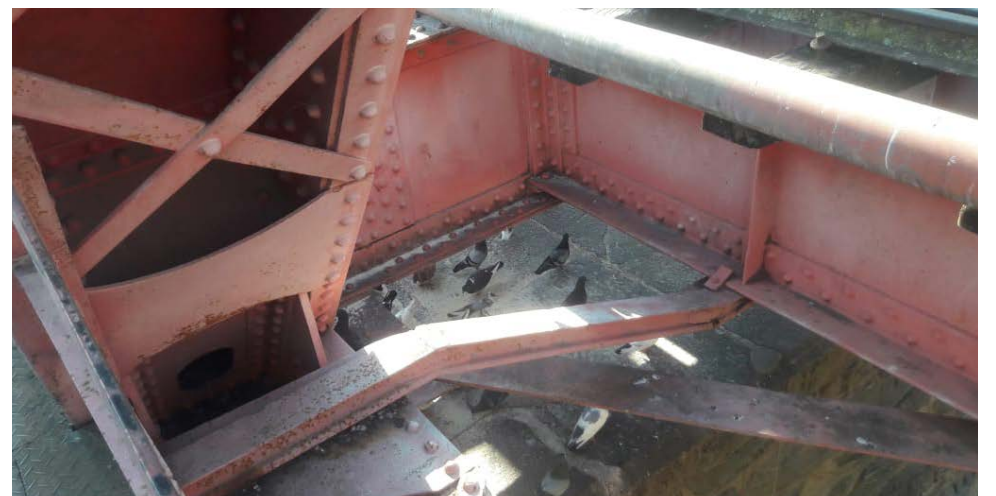
Os pombos urbanos estão sendo alimentados e afetando a estrutura das placas do Pontilhão de Ferro, em Ponte Nova
