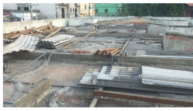
O início das obras provocaram a mudança de atendimento para a UBS Sette de Barros, que fica na Rua João Alves de Oliveira (Triângulo)
