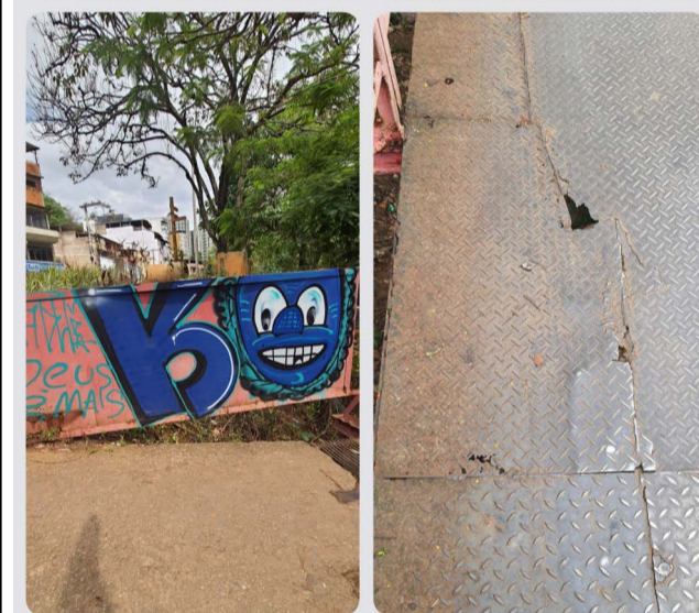
● Pichações e corrosão no Pontilhão de Ferro e no passadiço, causam preocupação aos usuários
