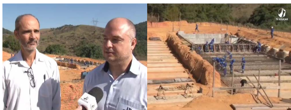
O Diretor-geral do DMAES, Anderson Sodré, em entrevista no canteiro de obras da ETE- Ponte Nova, ao lado do Prefeito Wagner Mol Guimarães
