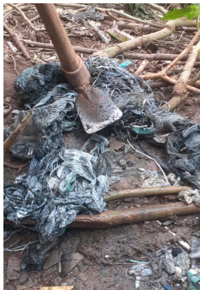
Material sólido que vem junto com o esgoto da Penitenciária de Ponte Nova I
