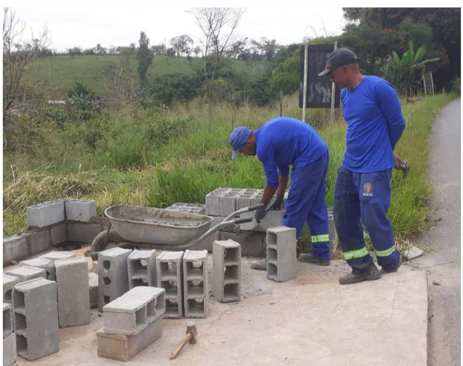
Construção de abrigo em ponto de ônibus da comunidade de Bom Será, nas imediações da Santinha do Vau Açu (MGC 120)
