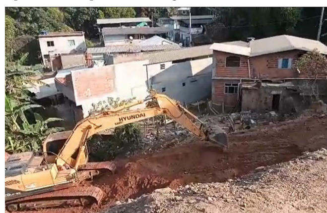
As obras forma paralisadas devido a chuvas no Pachequinho
