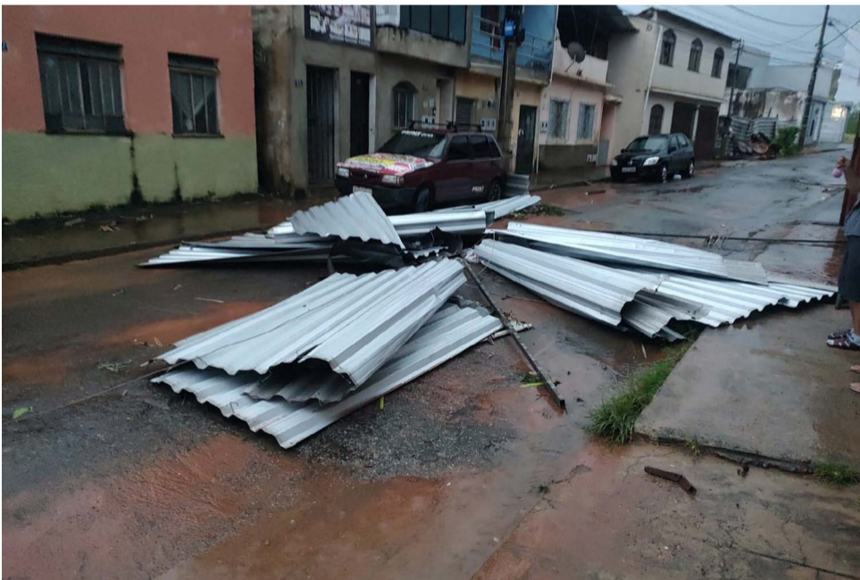
Ventania forte destruiu que telhados que foram parar no meio da rua, no Bairro Santo Antônio
