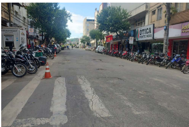
A Avenida Dr. Dr. Otávio Soares, em Palmeiras, também receberá a operação para tampar buracos e remodelar o piso para melhorar o tráfego de carros e pessoas
