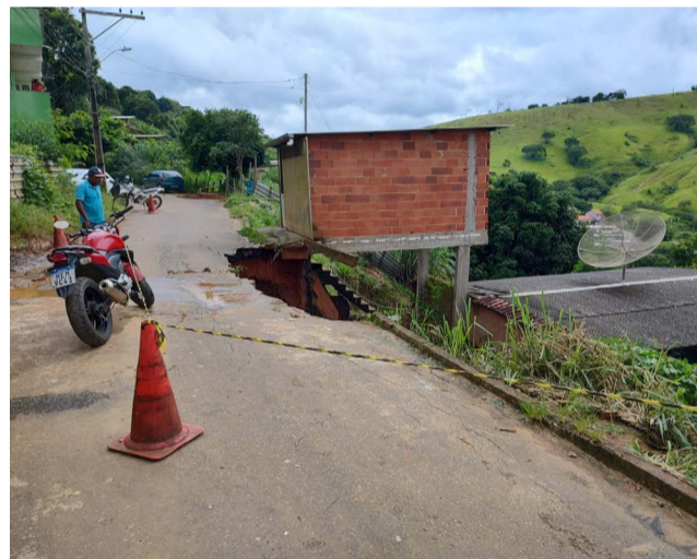
José Mauro Cirilo olha desconsolado a destruição do muro de contenção e o comprometimento de sua serralheria que ser derrubada para evitar uma tragédia
