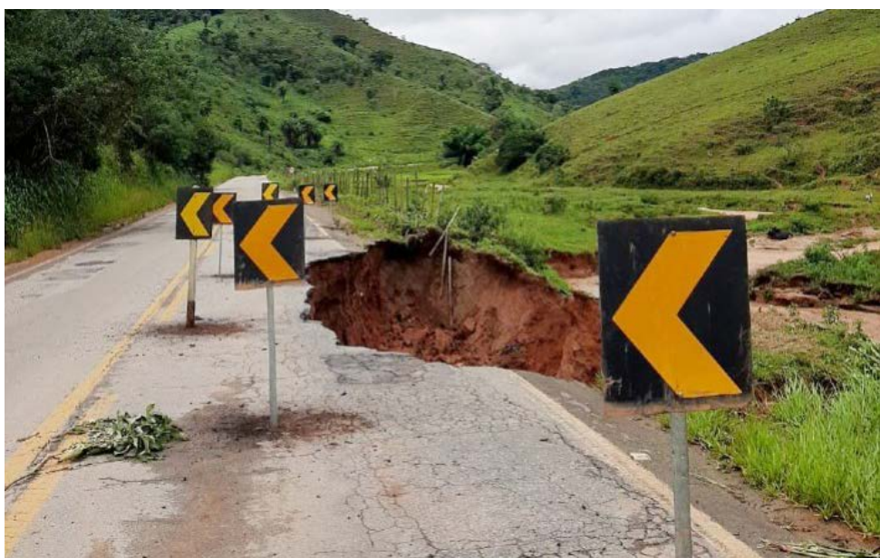
Buraco provocado por fortes mantém a MG-262 fluindo em apenas meia pista, perto do trevo de Acaiaca
