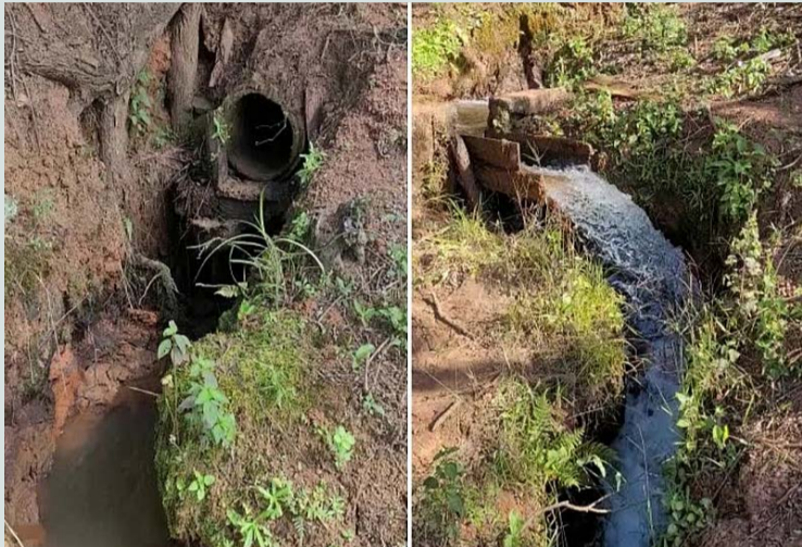
Depois das ações da ZMM a água parou de correr no leito do córrego Vista Alegre, em Teixeira (crédito: Rafaela Dotta)
