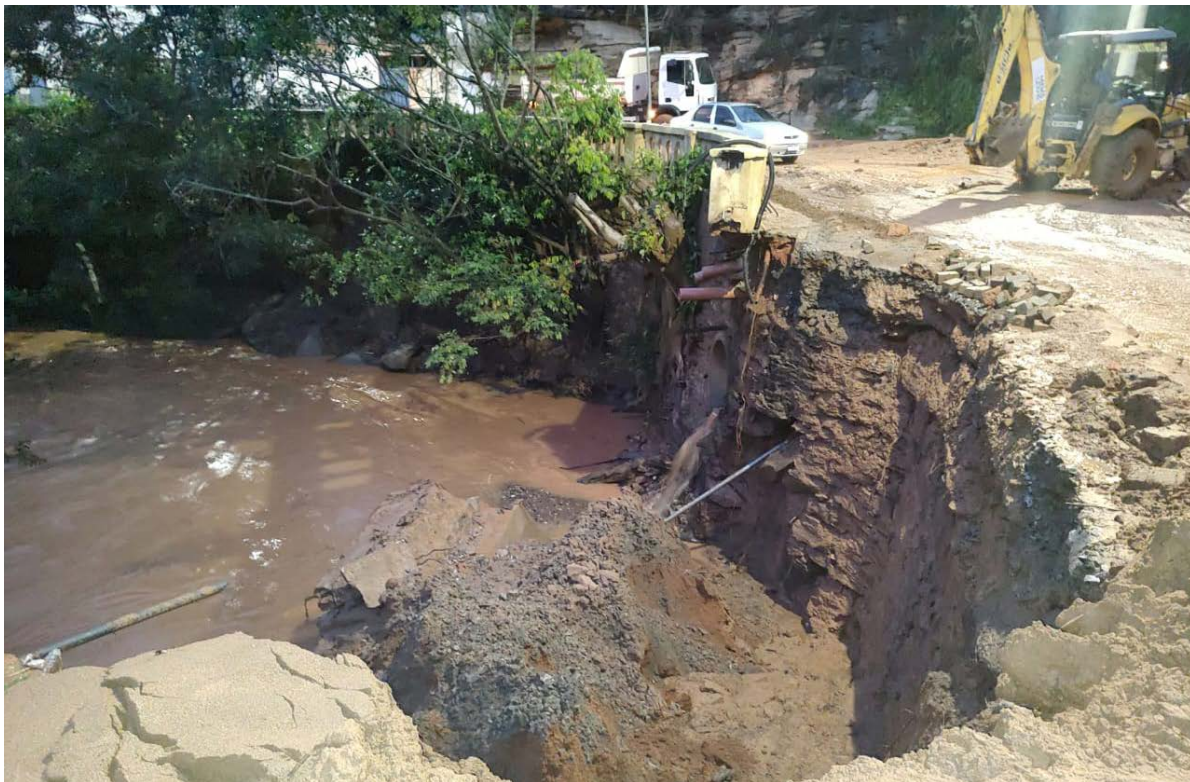
Chuva provocou carreamento de lama e barro do Bairro Cidade da Serra, que destruíram balaústre e muro de contenção na Rua Marcos Giardini, na entrada do Bairro Copacabana, que ficou ilhado por algumas horas
