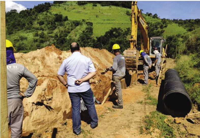
Os primeiros trabalhos aconteceram em janeiro de 2021 com a construção de tubulação para levar o esgoto até a ETE-Ponte Nova
