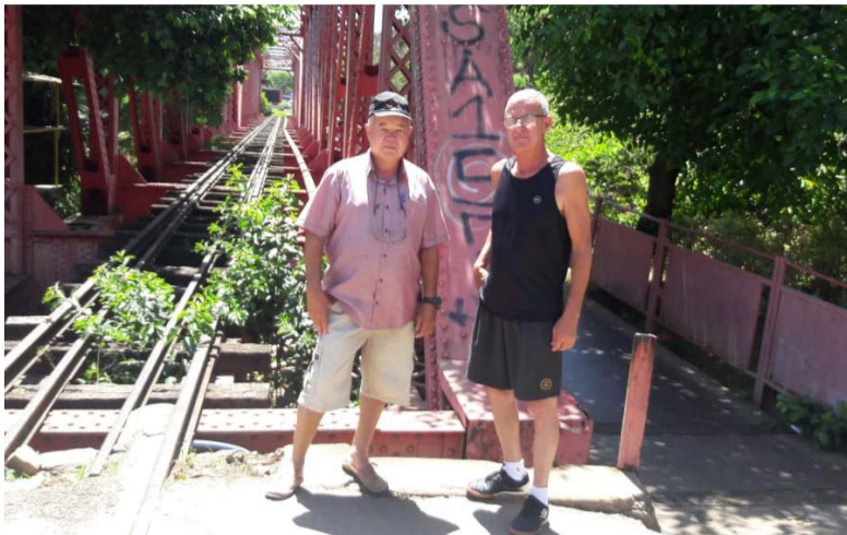
1 Gilson do SOS Mangueiras e Zé Osório na frente do Pontilhão de Ferro onde os buracos e a falta de dormentes (pranchões) oferecem perigo para os pedestres
